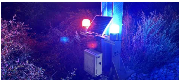
<경보장치 수신기 설치>
