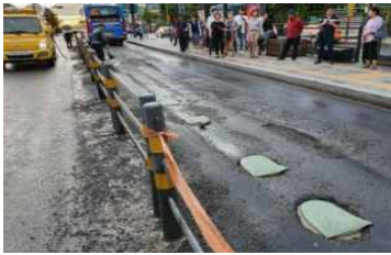
아스팔트 포장 파손
