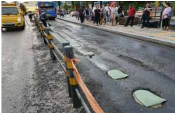
〈아스팔트 포장 파손〉
