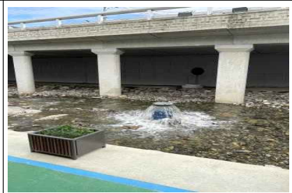
도림천 유지용수 공급시설
