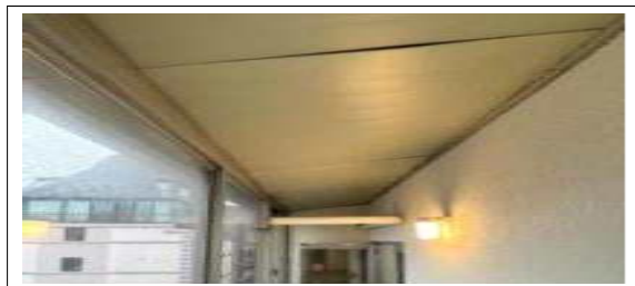
연소하기 쉬운 샌드위치 패널로 지붕 불법 증축(시정)
