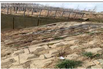
< 안양천 사면 침하 파손 >
