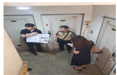
지하주택 119연계 비상벨 설치 (종로구)
